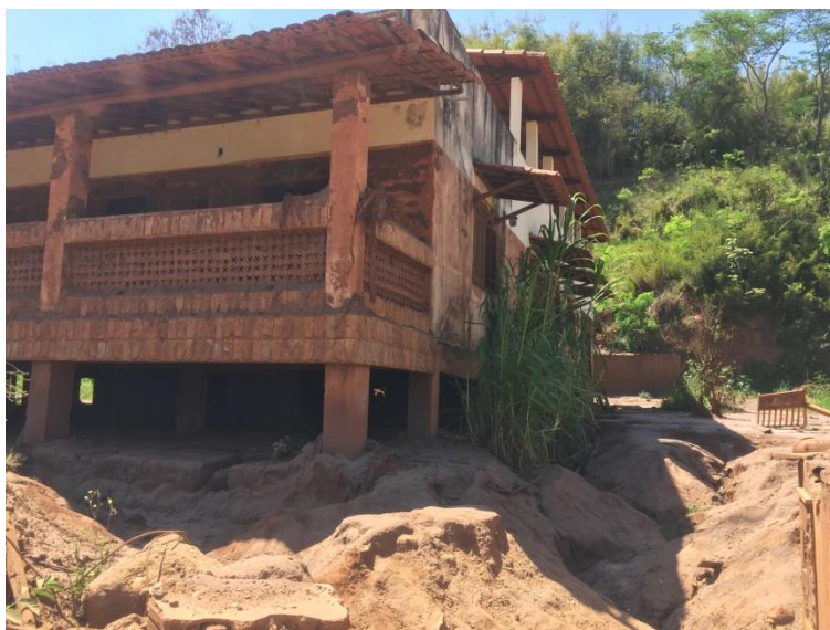
Figura 22- Imagem da região de Gesteira após o desastre
